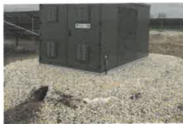
Figure 10 Terrier sous un poste de transformation - Centrale solaire de Blueberry à Châteauroux (36)
